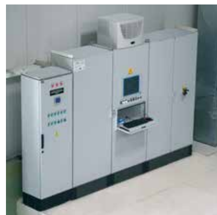
ПУЛЬТ УПРАВЛЕНИЯ ОЧИСТНЫМИ СООРУЖЕНИЯМИ
